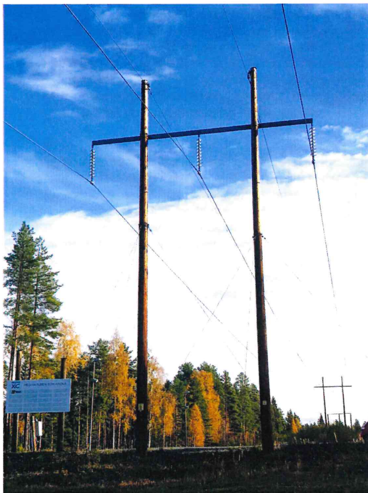
Figur 3-1. Exempel på en 170 kV-luftledning med topplina
